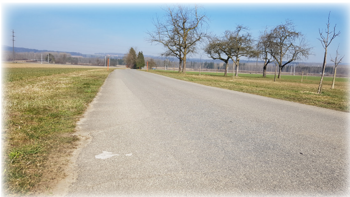
Die Wasenstrasse in Mettendorf ist sanierungsbedürftig
