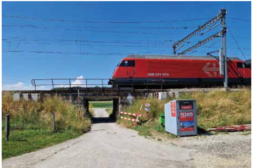
Die Bahnunterführung in Eschikofen ist in die Jahre gekommen. Sie soll geschlossen werden. Bild: Peter Maag
