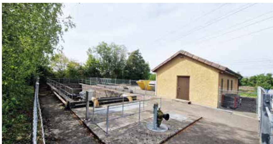
Die Abwasserreinigungsanlage in Mettendorf (Bild) wurde mit dem Beitritt zum Abwasserverband Region Frauenfeld stillgelegt.
